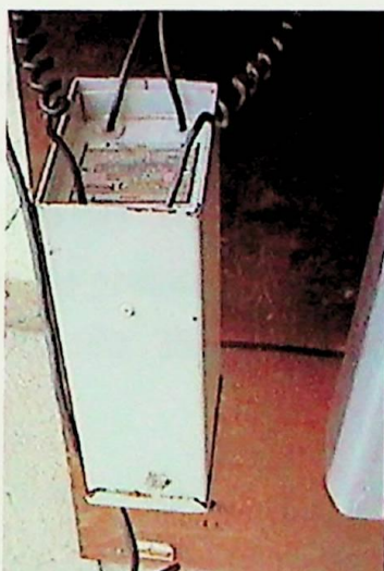
Figura 5.5 Reator da lâmpada de vapor de mercúrio de 250 W sem a marca de identificação
