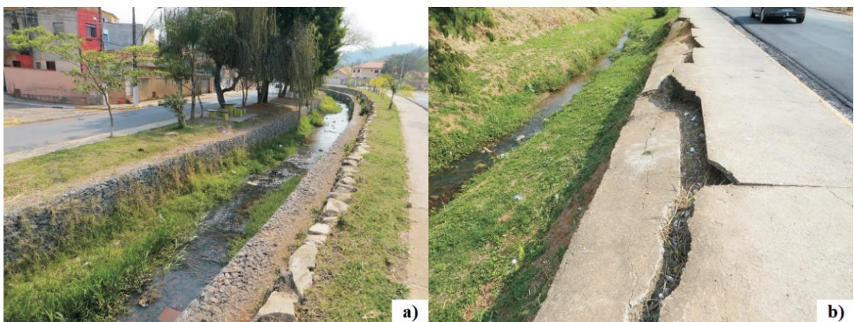
Figura 4.9 - Margem do Ribeirão José Pereira em pontos da área urbana: taludes marginais (a) e processo de solapamento em algumas partes desses taludes (b). Fonte: CPRM (2014)
