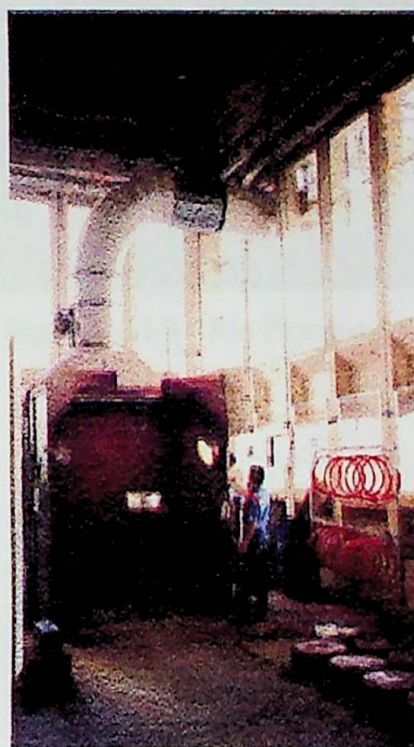
Figura 4.5.1.2 – Cabine de Pintura com Retificador de Fluxo
