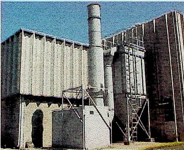
Figura 3.7.3 – Ausência de monitoramento no sistema de exaustão
