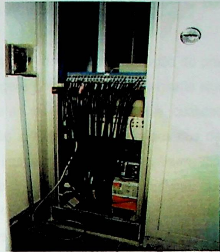
Fig 6.2.d) Cablagem da Interface IFDM
