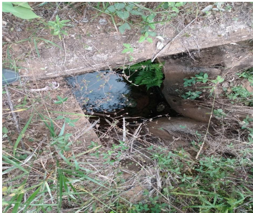
Figura 11 – Nascente principal do córrego Entre Folhas – Minas Gerais retida juntamente com a drenagem pluvial da Rodovia MG – 425
