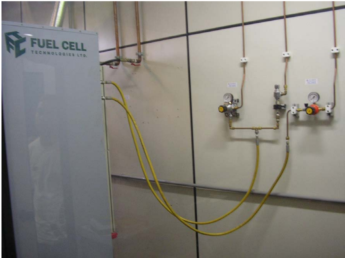
Figura 62 Sistema de fornecimento de combustível e NHMix.
