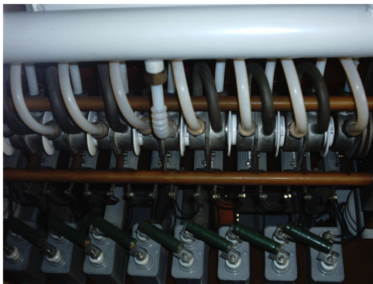
Figuras 5.15 – Compensador estático de reativos do tipo capacitores chaveados a tiristores.
