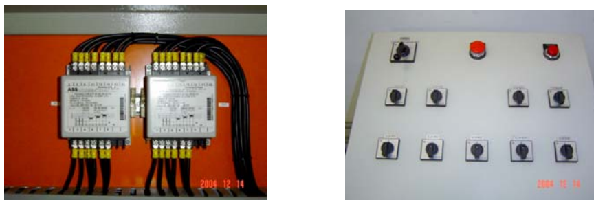
Figura 31 – Medição de Potência Elétrica e Painel de Carga Isolada
