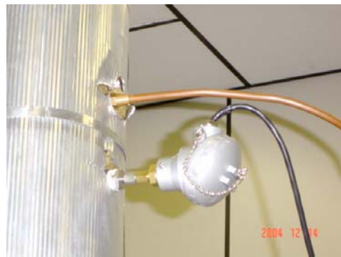
Figura 30 – Medição de Pressão e Temperatura na Chaminé
