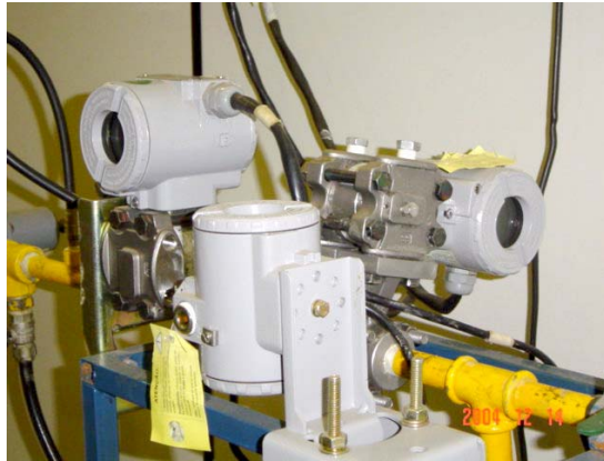
Figura 27 – Medição de Vazão de Gás
