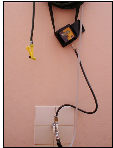
Figura 4.27- Data-Logger instalado na Rua das Rosas, nº 15
