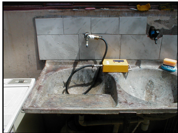
Figura 4.6- Data-Logger de pressão instalado na Rua Geraldo Francisco, nº 41 Bairro Faisqueira
