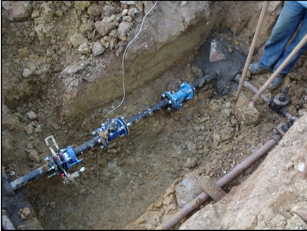
Figura 4.29- Filtro, hidrômetro e VRP de DN 50 mm
