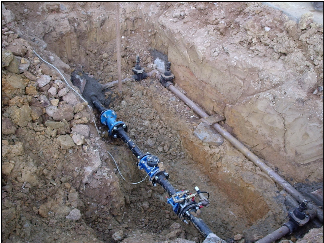
Figura 4.28- Sistema de controle e redução de pressão instalado
