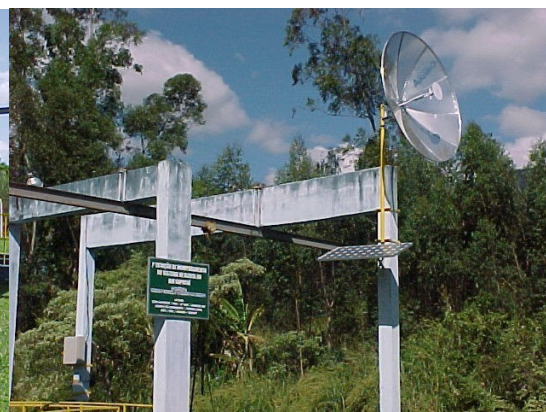
FIGURA 4.16 – Painel solar e antena de transmissão.
