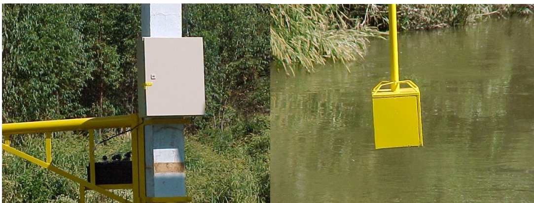
FIGURA 4.17- Bateria e central de transmissão.
