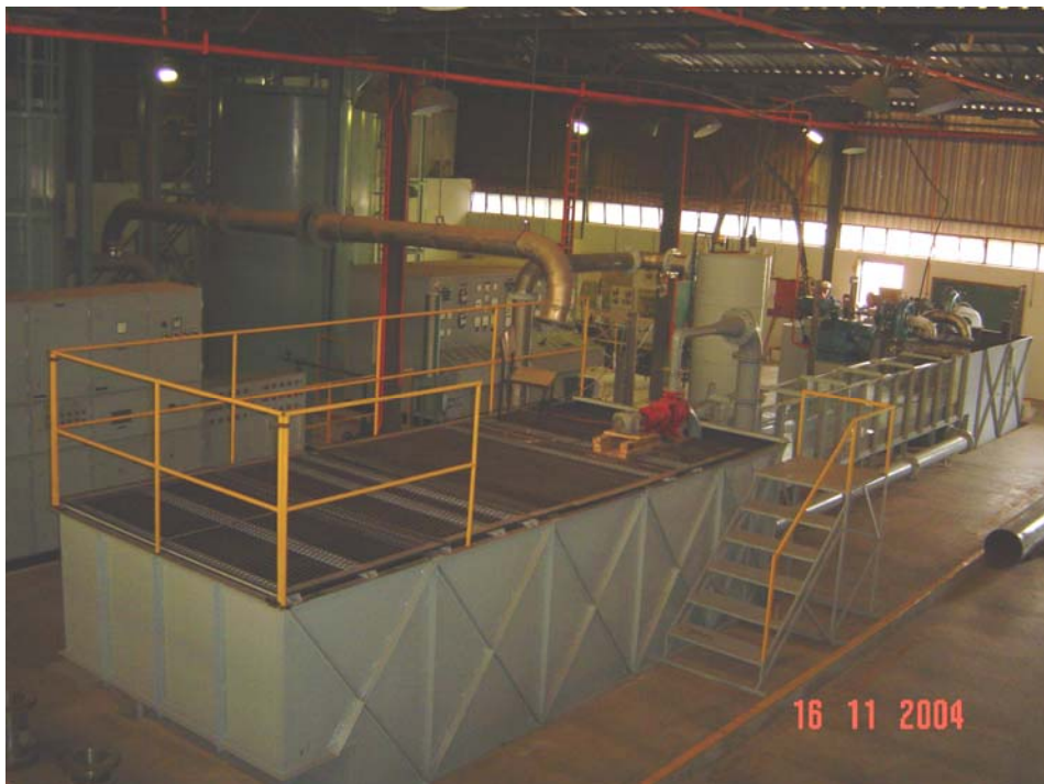
Figura III.5 – Vista geral do Laboratório Hidromecânico para Pequenas Centrais Hidroelétricas (LHPCH)
