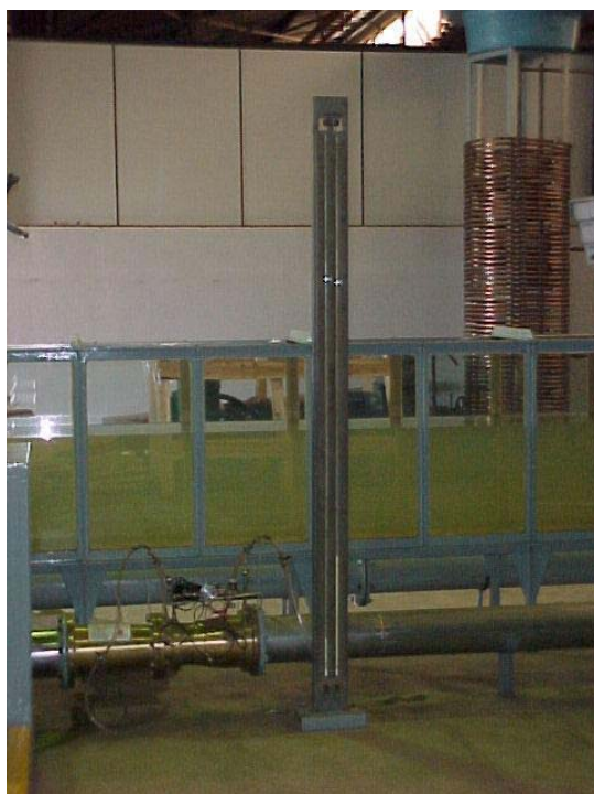
Figura III.12 – Manômetro invertido de colunas de mercúrio do medidor Venturi
