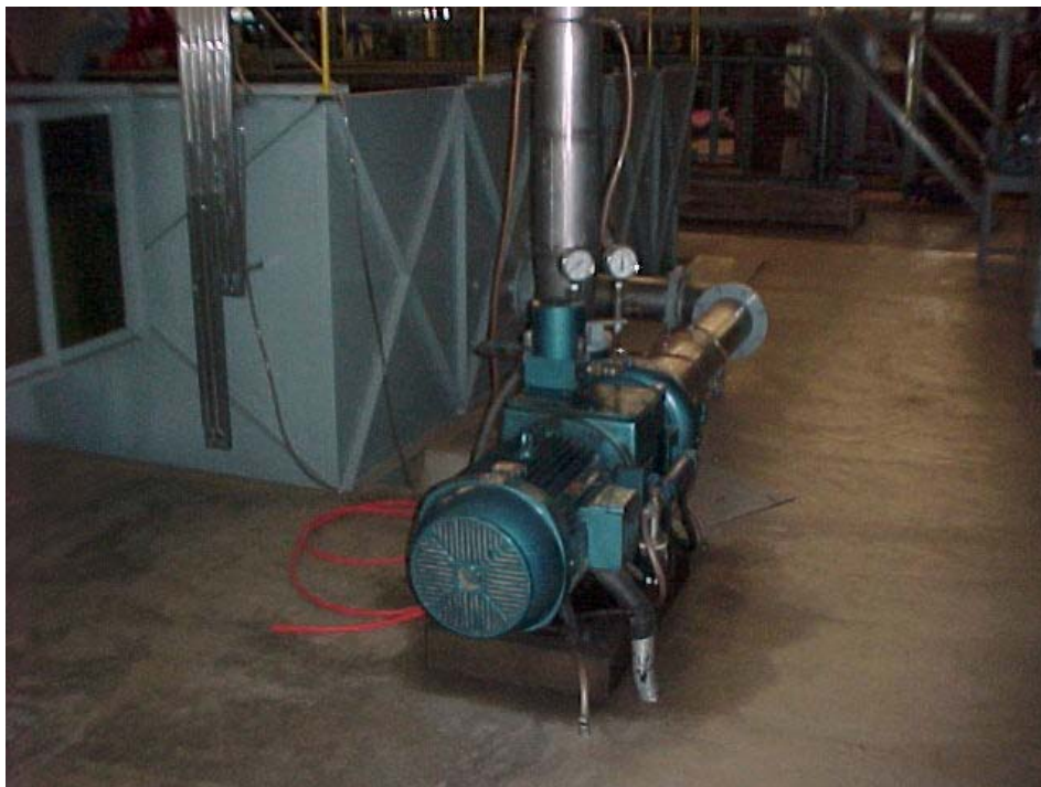
Figura III.8 – Bomba utilizada para simular a altura e a vazão da BFT
