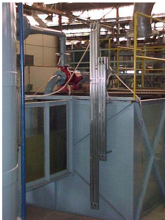
Figura III.10 – Manômetro de colunas de mercúrio para medição da pressão manométrica na entrada da BFT
