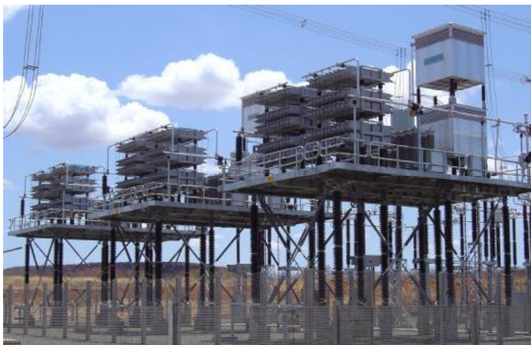
Fig.7.1 – Foto da Compensação Série Fixa 1 (CSF 1) instalada na LT 500 kV Boa Esperança (PI) - São João do Piauí (PI)
