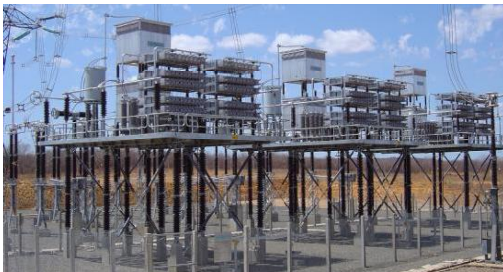
Fig.7.2 – Foto da Compensação Série Fixa 2 (CSF 2) instalada na LT 500 kV São João do Piauí (PI) - Sobradinho (PE)
