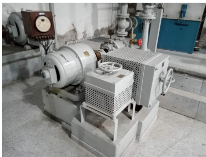
Figura 4 - Bomba hidráulica e reostatos.
