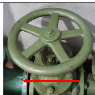
Fig. 47 - Válvula (V3) fechada.
