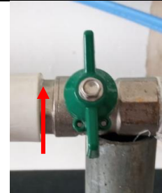
Fig. 41 - Válvula (V9) fechada.
