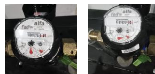
Fig. 43 – Hidrômetros (H1) e (H2).
