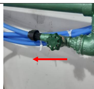
Fig. 45 - Válvula (V7) fechada.
