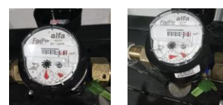
Fig.42 – Hidrômetros (H1) e (H2).
