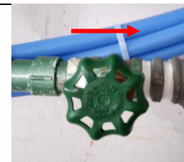
Fig. 9 - válvula gaveta de alimentação do sistema secundário (V7).
