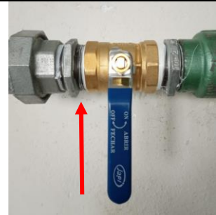
Fig. 6 - Válvula esférica de alimentação do circuito (V4).
