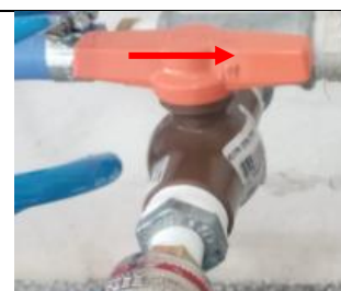
Fig. 9 - válvula esférica de injeção de ar (V7).
