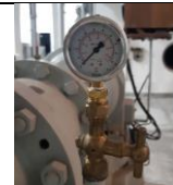
Fig. 27- Manômetro da bomba (M1)
