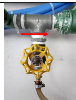
Fig. 7 - Válvula gaveta do sistema secundário (V5).
