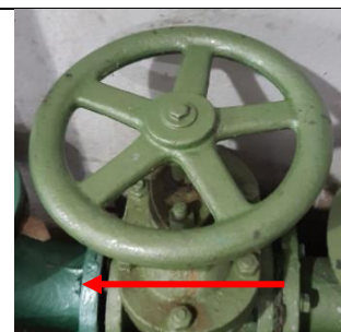
Fig. 52 - Válvula (V3) fechada.
