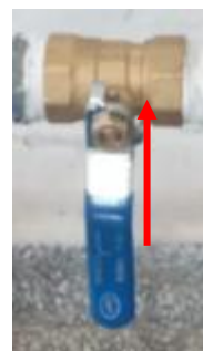
Fig. 50 - Válvula (V6) fechada.
