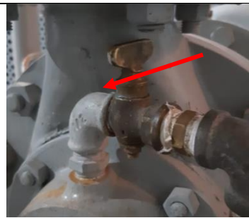
Fig. 55 - Válvula de resfriamento da Bomba (B1).
