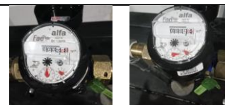
Fig. 47 - Hidrômetros (H1) e (H2).
