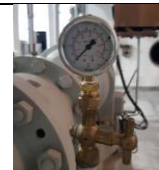
Fig. 26 - Manômetro da bomba (M1).
