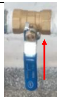
Fig. 46 - Válvula (V6) fechada.
