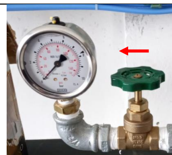
Fig. 43 - Válvula (V8) fechada.
