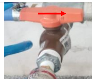
Fig. 8 - válvula esférica de injeção de ar (V7).
