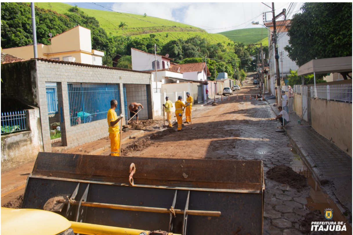
Figura 4.19 - Rua Antônio Pereira Macedo, no bairro Vila Isabel, durante limpeza após chuva intensa em janeiro de 2021
