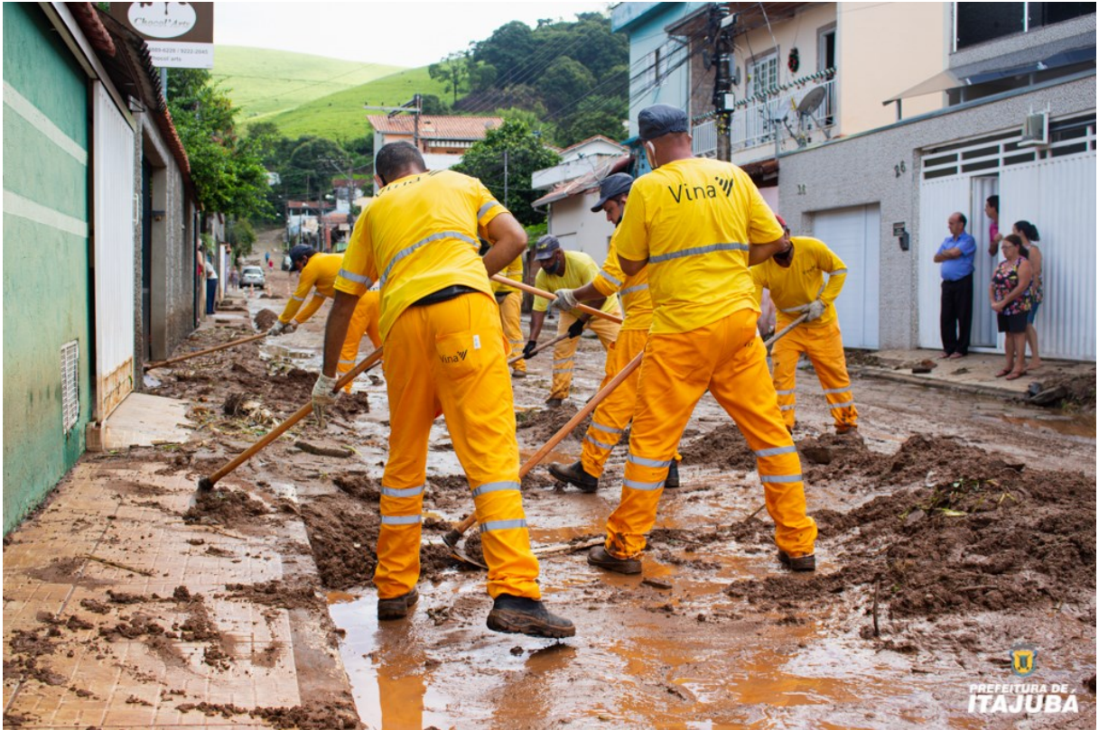
Figura 4.18 - Limpeza da Rua Antônio Pereira Macedo, no bairro Vila Isabel, após chuva intensa em janeiro de 2021
