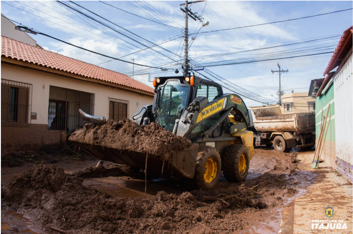
Figura 4.20 - Limpeza das ruas no bairro Vila Isabel após a chuva intensa de janeiro de 2021
