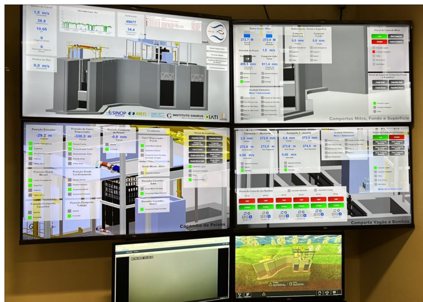
Figura 40 – Disposição das telas na sala de controle e monitoramento.
