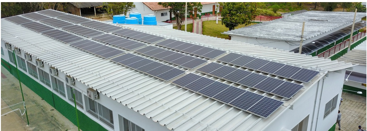
Figura 4.1 – Painéis fotovoltaicos instalados sobre o Laboratório de Alimentos do Instituto Federal do Sul de Minas, Campus Carmo de Minas
