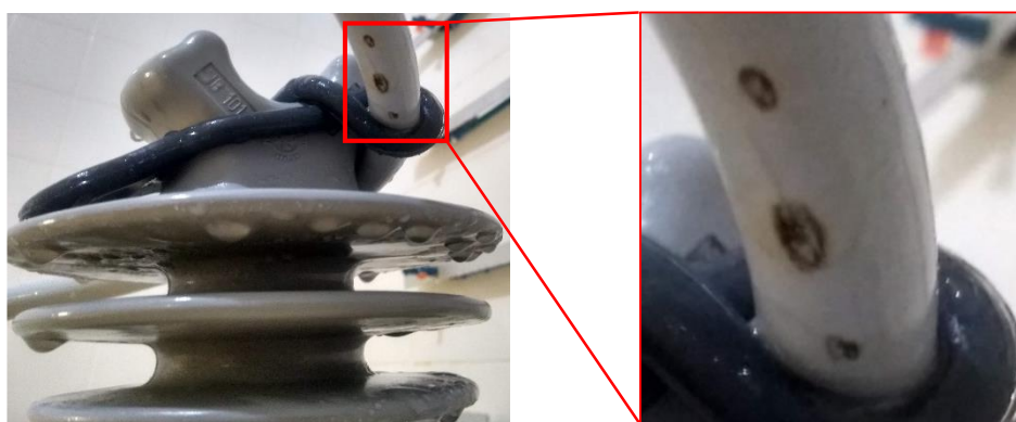
Figura 58 – Erosão no cabo coberto próximo ao isolador durante o ensaio de envelhecimento de 1000 horas por meio do primeiro método. Fonte: próprio autor.
