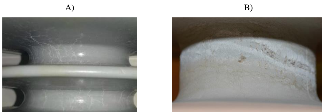
Figura 18 – Exemplos de trilhamento e erosão: A) Isoladores poliméricos - Fonte: [37]; B) Invólucro de para-raios - Fonte: [33].
