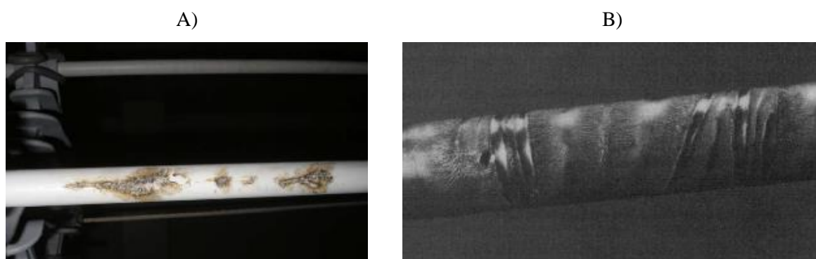
Figura 17 – Exemplos de trilhamento e erosão: A) Cabo coberto - Fonte: [20]; B) Cabo coberto com presença de trilhamento e erosão no ponto de conexão com o isolador - Fonte: [57].
