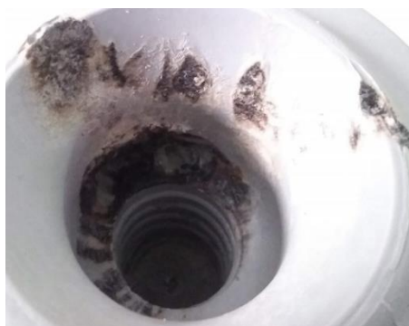
Figura 62 – Isolador substituído durante o ensaio de envelhecimento em 500 horas do segundo método, devido à grande área carbonizada. Fonte: próprio autor.
