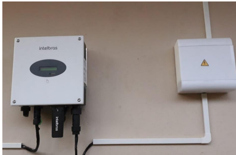
Figura 2 - INVERSOR ON GRID E SISTEMA DE PROTEÇÃO
