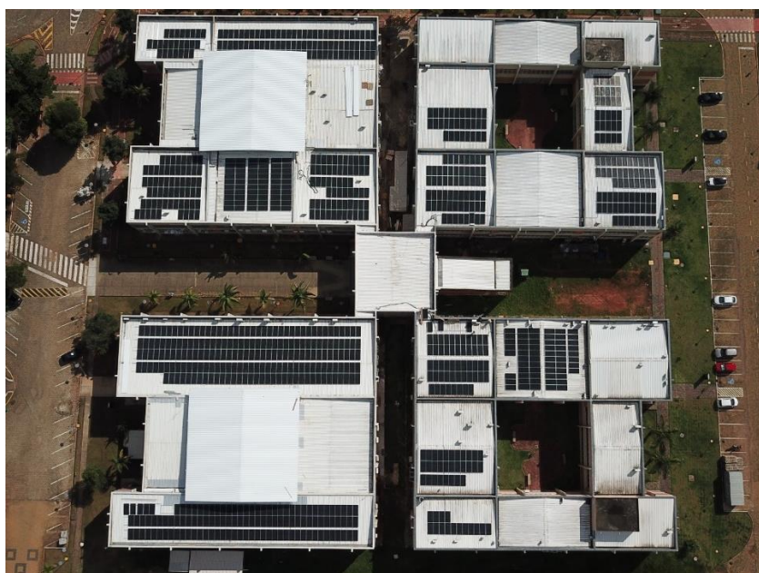
Figura 6-5 – Vista aérea da instalação do sistema fotovoltaico na UNIFEI.
