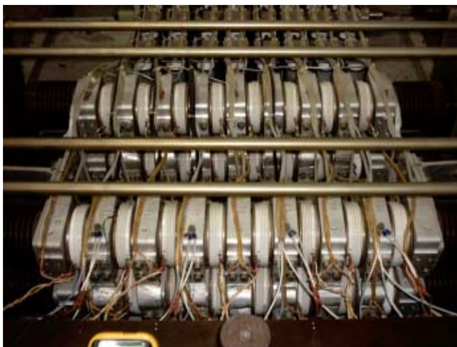
Figura 3.11 – Módulo de tiristores da válvula do CE da subestação de Fortaleza.
