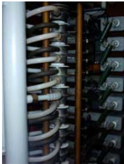
Figura 3.13- Válvula do CE da subestação de Mossoró.
