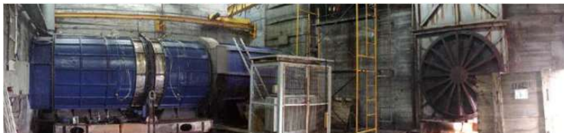
Figura 2.18 – Vista de alguns detalhes do interior da Usina do Pico
