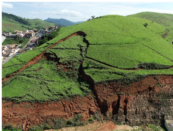
Foto E1: Direção norte-nordeste, deslizamento de terra, face central.
