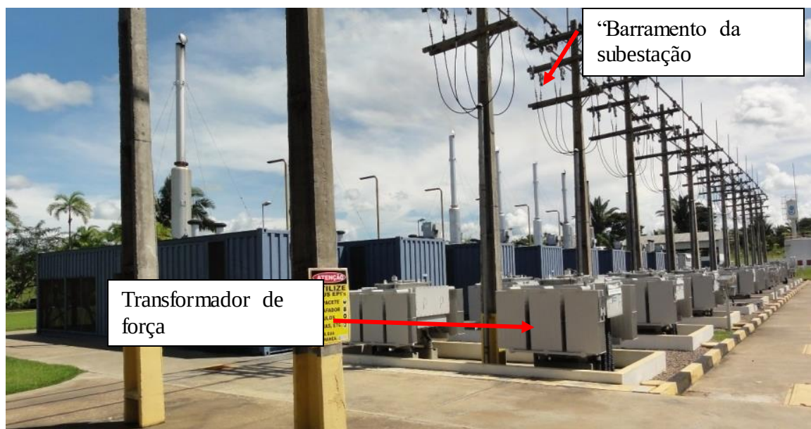
Figura 2-19 Unidades geradoras e transformadores elevadores de tensão
