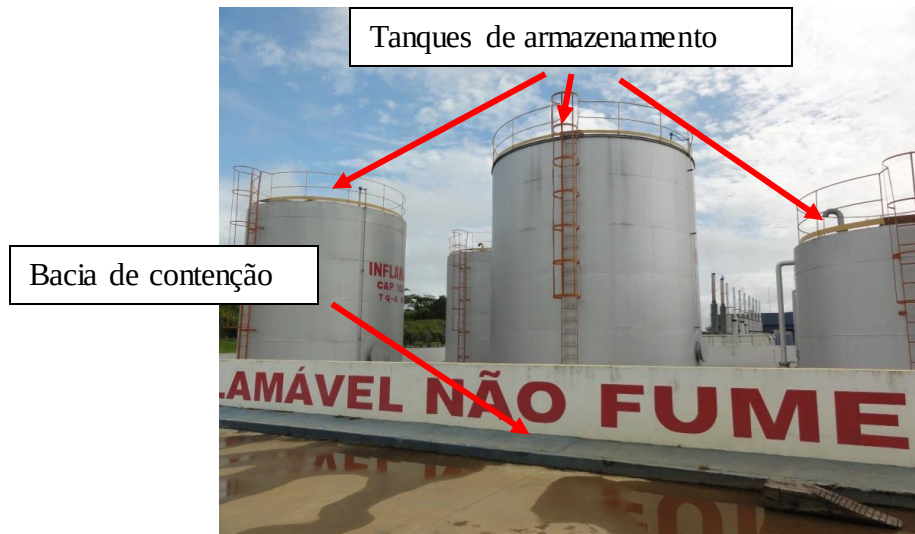
Figura 2-16 Tanques de armazenamento (visão 1)
