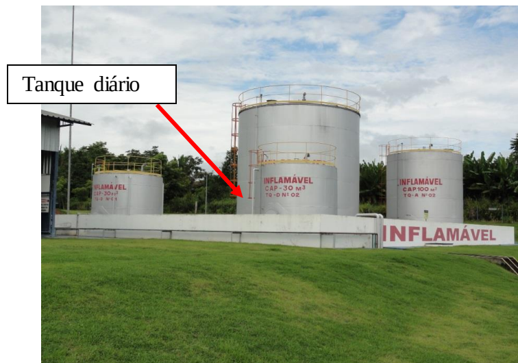
Figura 2-17 Tanques de armazenamento (visão 2)
