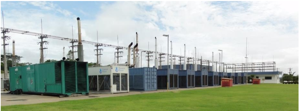
Figura 2-18 Unidades geradoras no pátio da UTE
