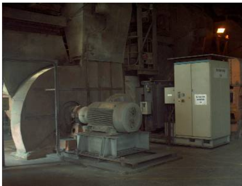
Figura 5.7: Foto do ventilador de ar primário para os queimadores. Fonte: AES Drax Power Ltd (2002).
