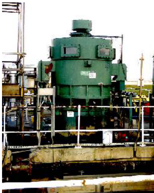
Figura 5.11: Foto de uma das bombas de recalque da água do rio Ouse. Fonte: AES Drax Power Ltd (2002).
