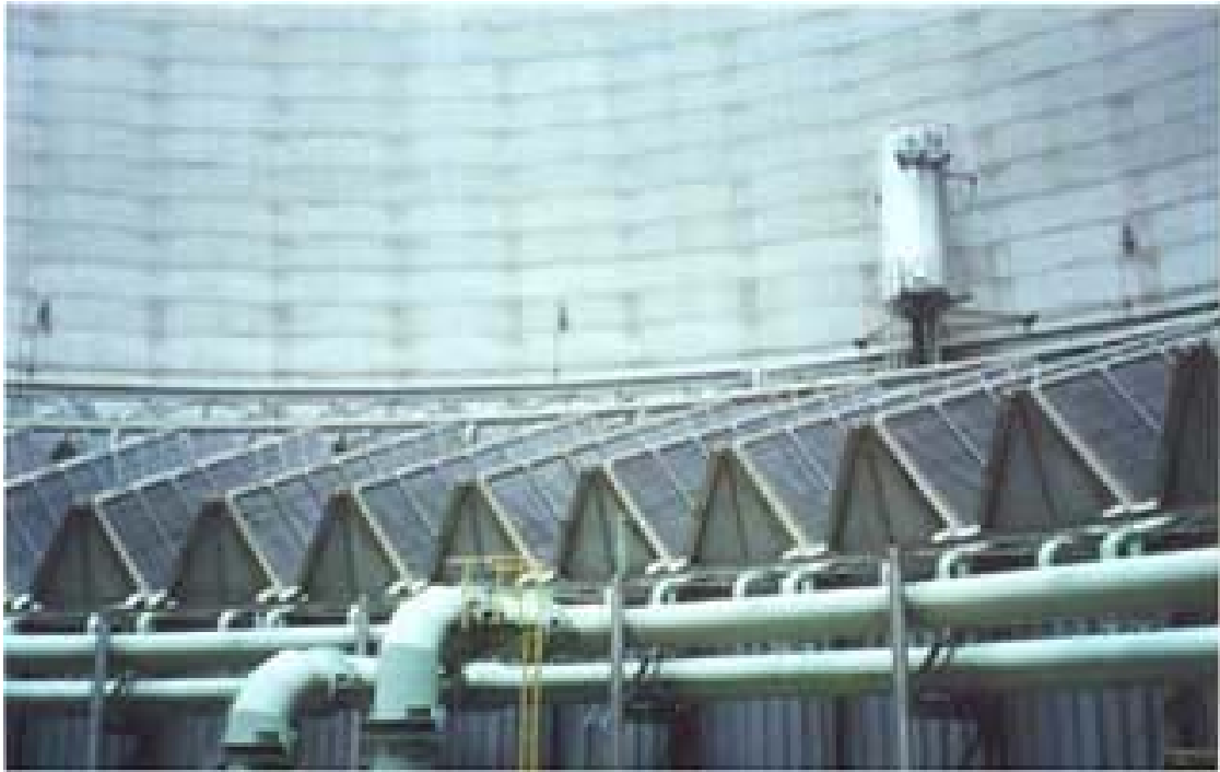
Figura 2.81: Detalhe dos radiadores d'água e tubulação da torre de resfriamento seca. Fonte: Companhia de Geração Térmica de Energia Elétrica (2000).
