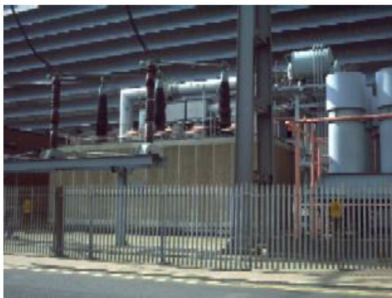
Figura 5.19: Foto do transformador de corrente elétrica de Drax. Fonte: AES Drax Power Ltd (2002).
