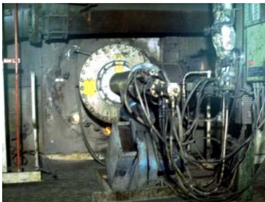
Figura 5.6: Foto de um queimador da caldeira aquatubular. Fonte: AES Drax Power Ltd (2002).
