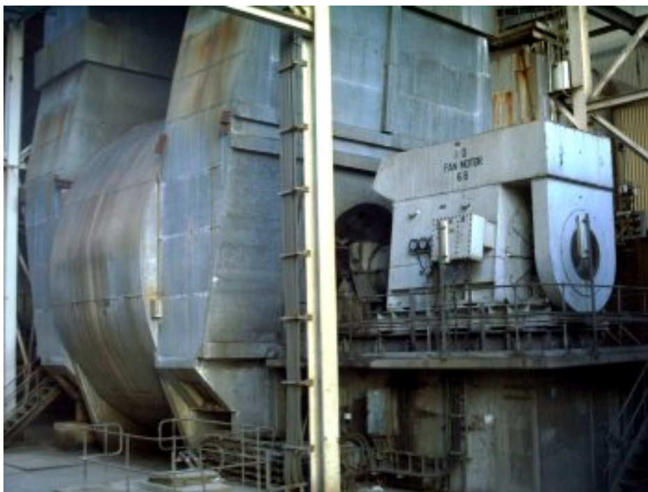
Figura 5.8: Foto do ventilador de corrente induzida. Fonte: AES Drax Power Ltd (2002).
