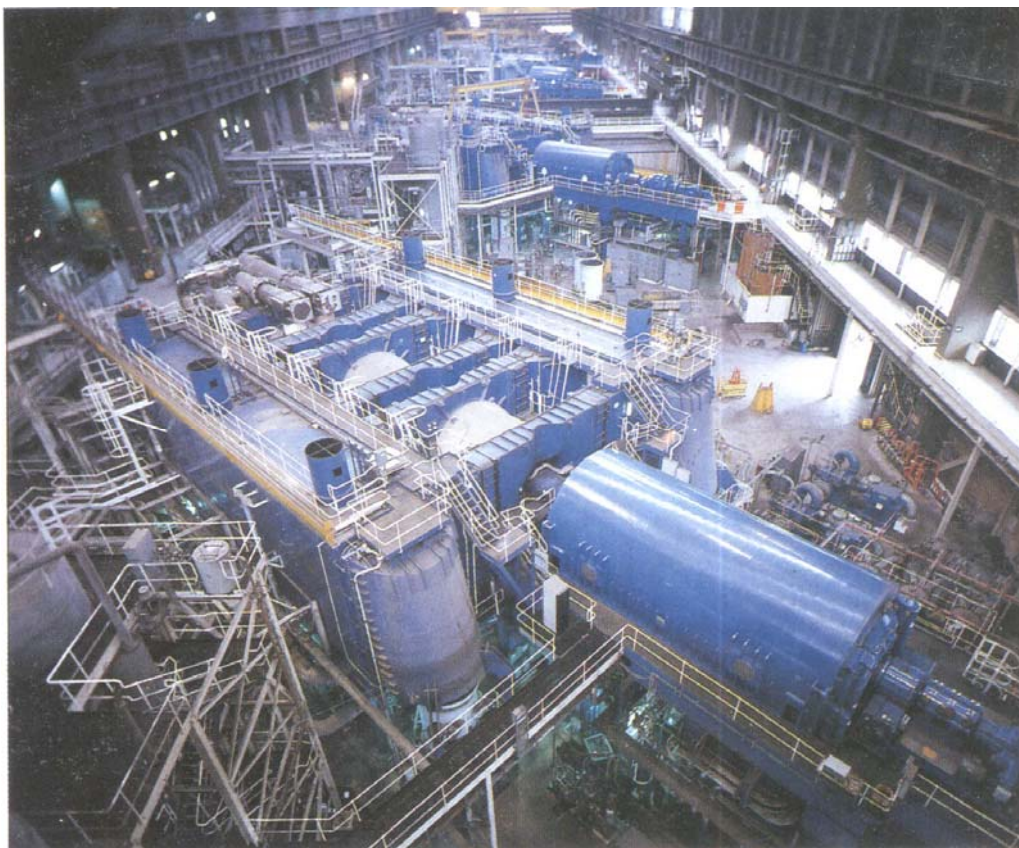
Figura 5.10: Casa das turbinas do complexo Drax. Fonte: "Modern Power Systems" (1986).
