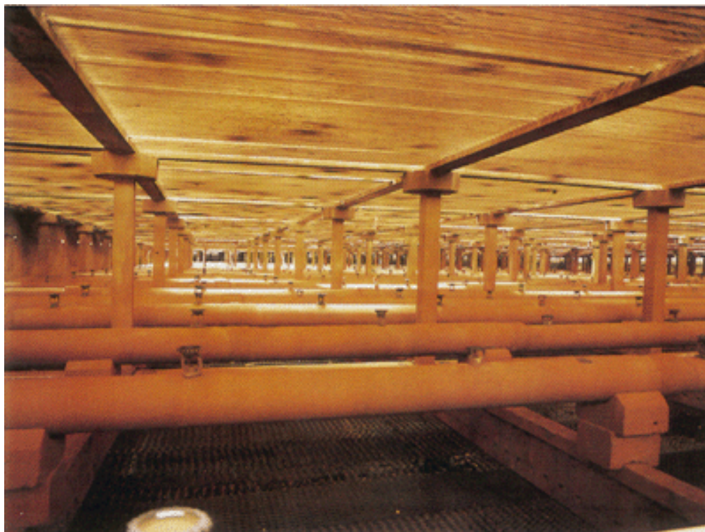
Figura 5.15: Vista parcial do sistema de distribuição de água da torre de resfriamento. Fonte: Munters UK (2003).
