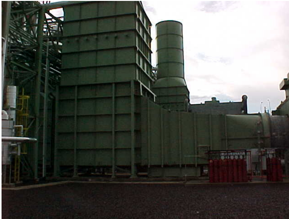
Figura 4.19 – Câmara de bypass ( Damper ).
