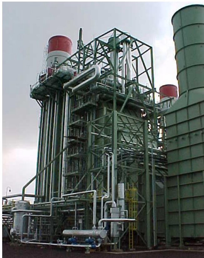
Figura 4.13 - Caldeira de recuperação sem queima suplementar.
