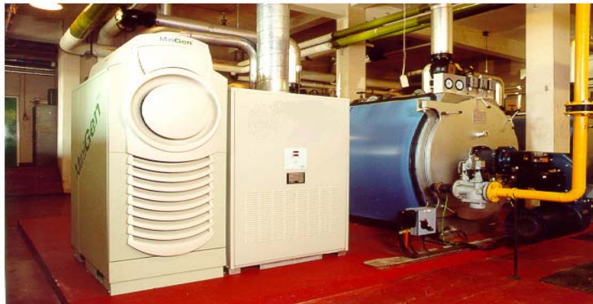
Figura 3.14 - Sistema de cogeração utilizando micro-turbina e caldeira (Pierce, 2002)
