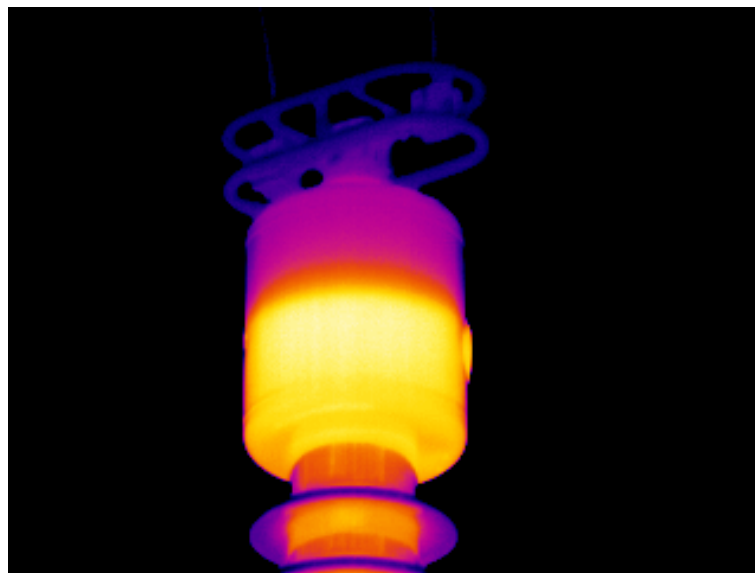
Figura 5 – Termograma de um Transformador de Potencial e a visualização do nível de óleo.
