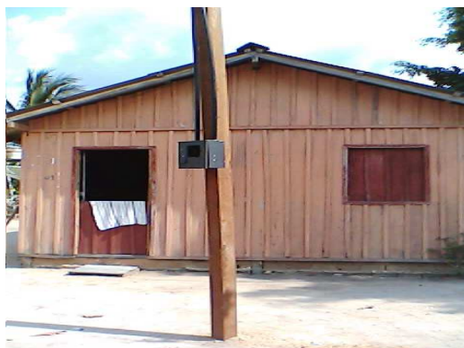
Figura 5.11 - “Padrão” instalado a espera da ligação.
