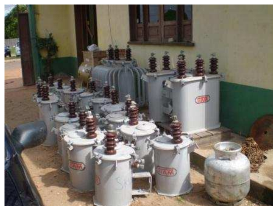
Figura 5.7 – Transformador elevador e transformadores abaixadores.
