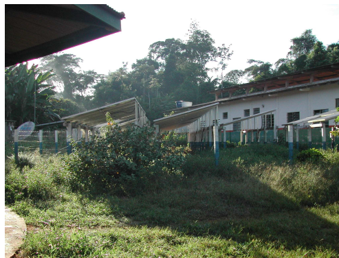
Figura 5.17 - Painéis fotovoltaicos da escola da comunidade de Canaã.
