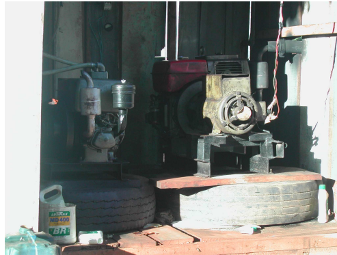
Figura 5.16 – Gerador diesel usado na comunidade de Canaã.
