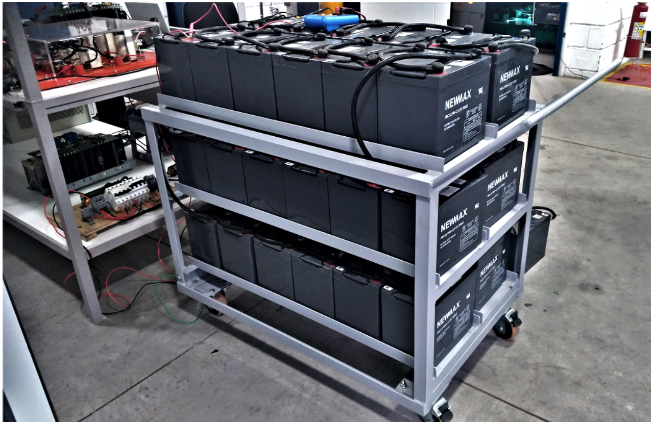
Figura 61 – Banco de baterias.
