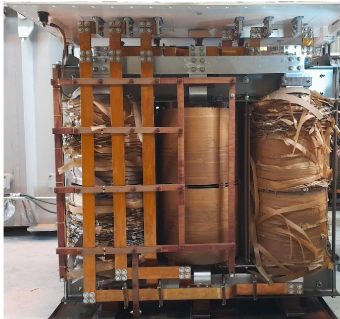
Figura 12 – Imagem de bobinas com apresentação de falha de sobrecarga elétrica
