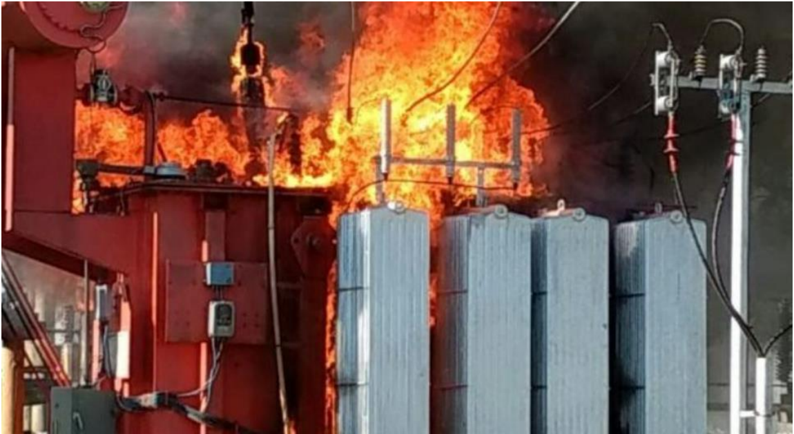
Figura 4 – Imagem de explosão de transformador de potência
