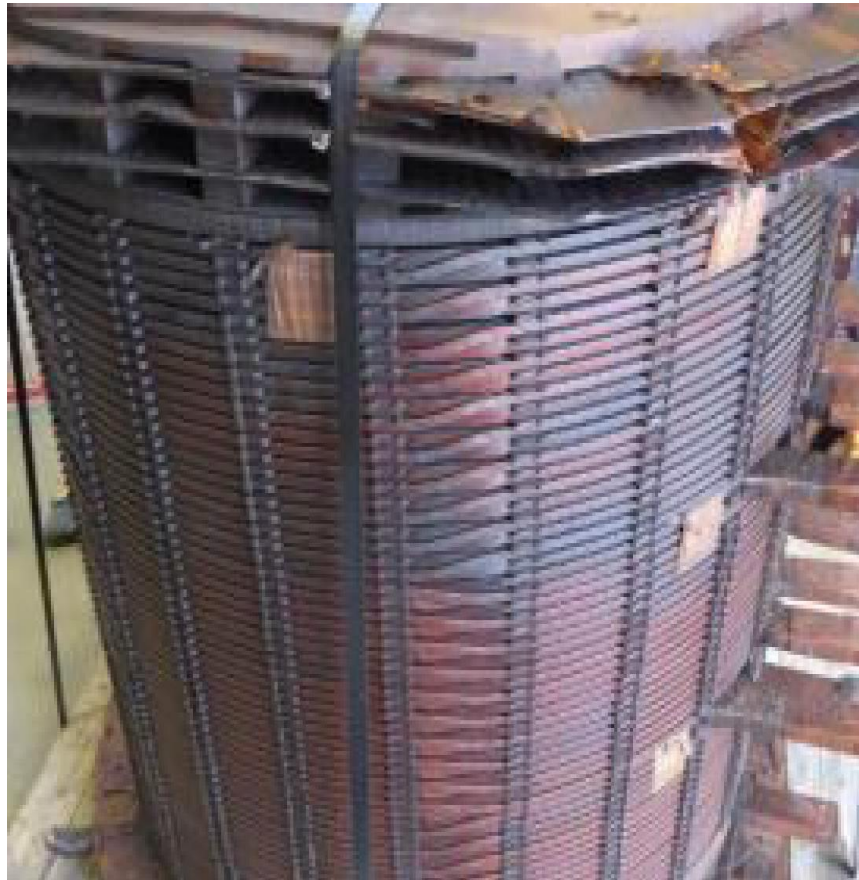
Figura 13 – Imagem do topo dos enrolamentos degradados devido a variação da distribuição da temperatura dentro do tanque do transformador
