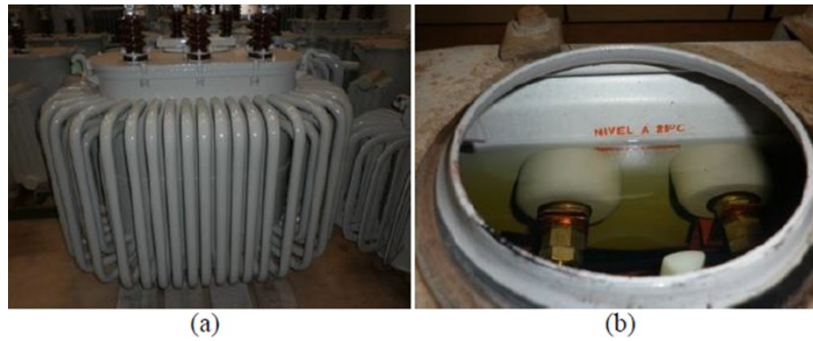
Figura 1 – Transformador de distribuição (a) e tanque contendo núcleo ativo imerso no fluido isolante (b).
