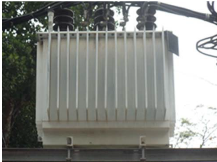
Figura 4 – Transformador preenchido com óleo de coco instalado em 2001 em Wathara, Kesbewa, Sri Lanka.
