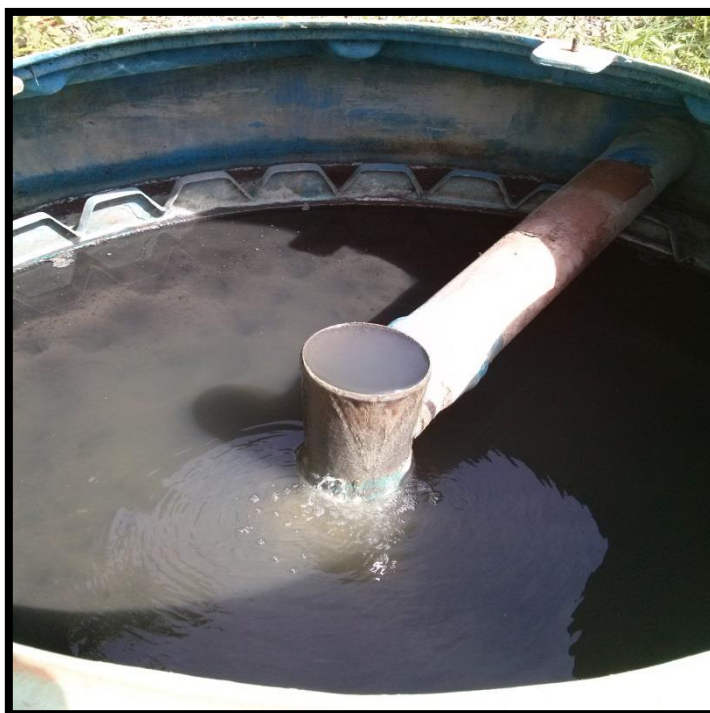
Figura 17 - Imagem da parte interna do Filtro Anaeróbio, demonstrando onde ocorre a formação de cascata.
