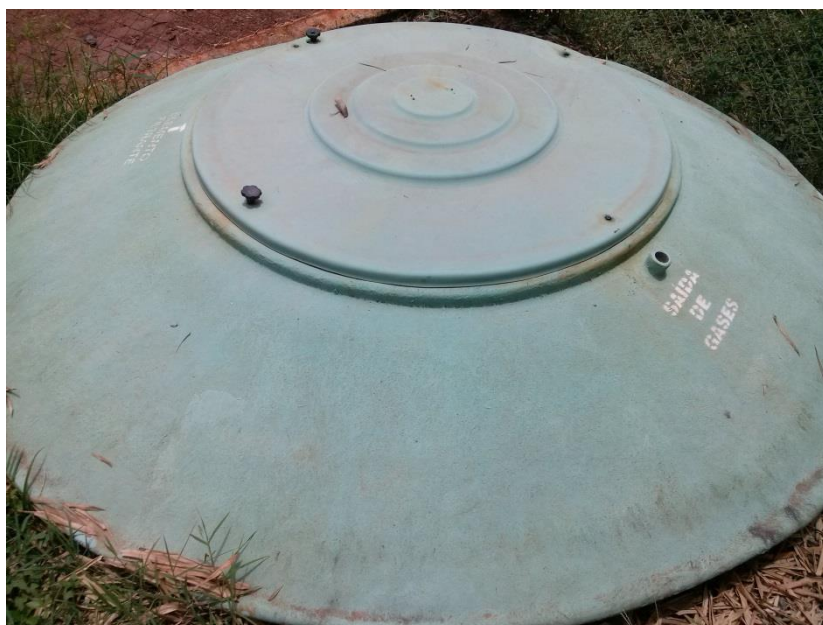
Figura 12 - Saída de gases do reator UASB.
