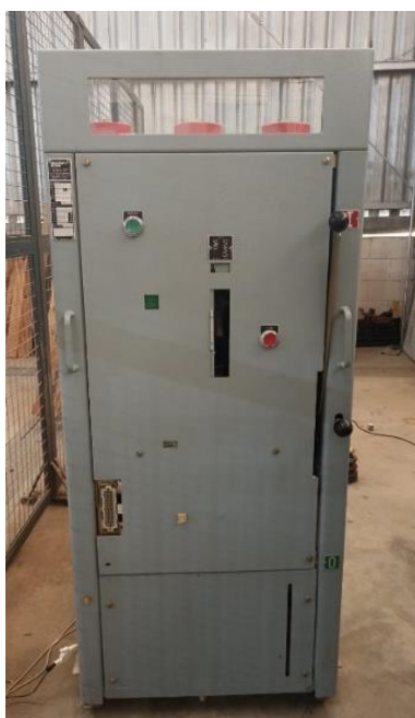
Figura 38 - Disjuntor de média tensão
