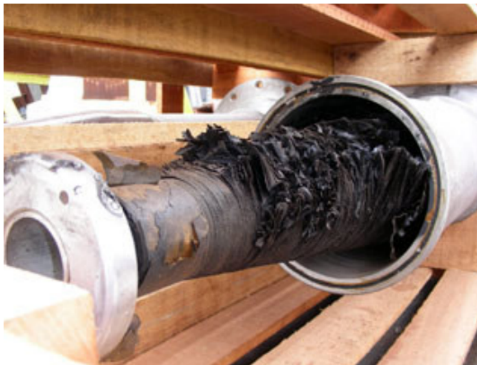
Figura 6: Exemplo de falha no tap capacitivo de uma bucha de alta tensão [14].
