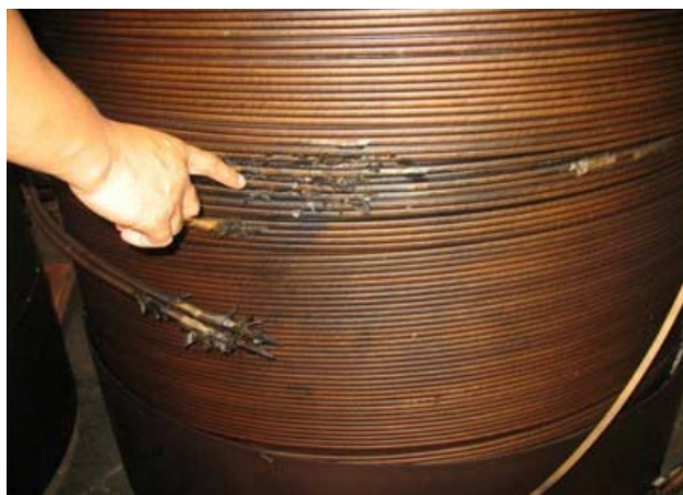
Figura 4: Exemplo de falha nos enrolamentos de um transformadores de potência [31].
