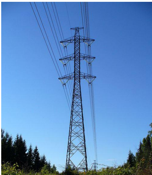
(c) cabos de torre de transmissão de eletricidade.
