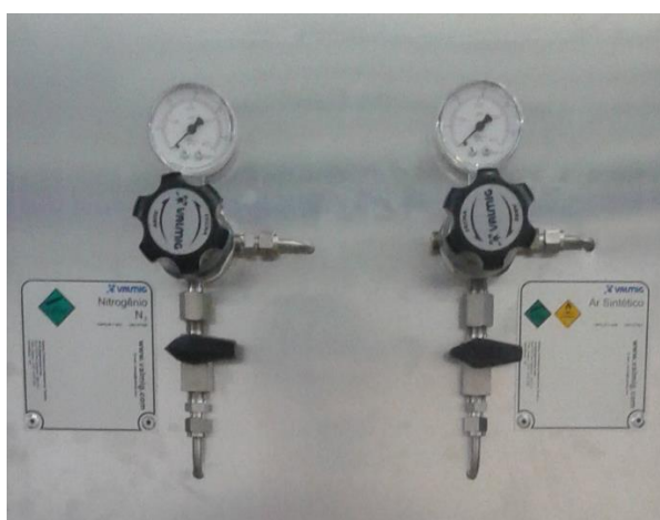
Figura 6. 4 Válvulas de posto na bancada.
