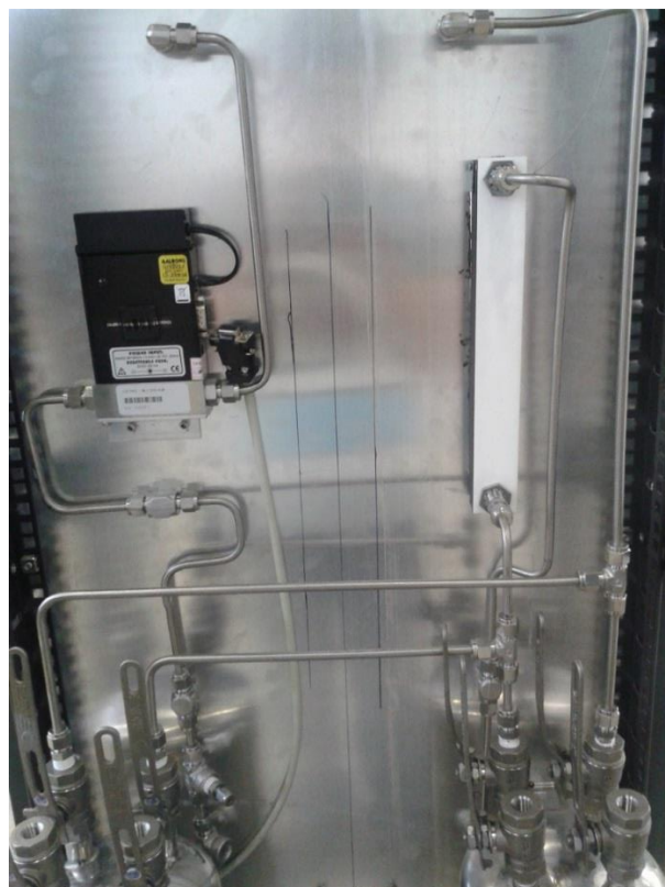
Figura 6. 11 conexões das tubulações com os depósitos e os sensores.
