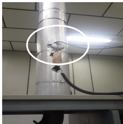
Figura 4.9 - Chaminé e termopar de temperatura.
