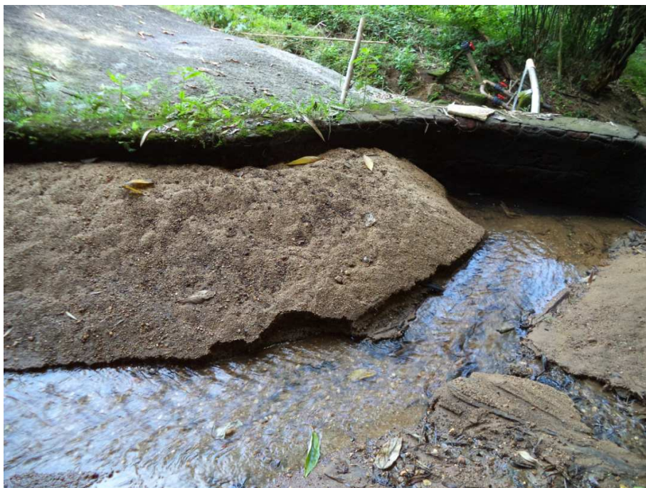
Figura 3.15- Pequena barragem assoreada
