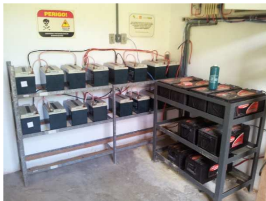
b) Banco de baterias
