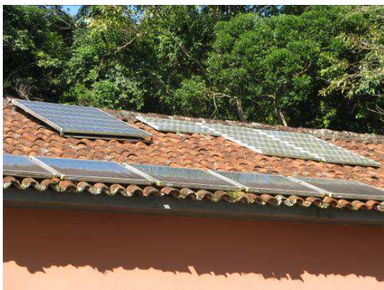
Figura 3.3- a) Painéis fotovoltaicos instalados
