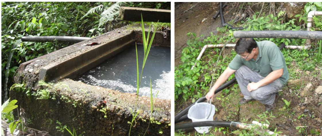
Figura 3. 10- Medidas de vazão perdida pelo ladrão
