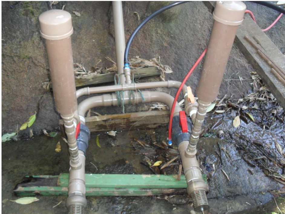
Figura 4.60- Carneiros hidráulicos após alterações
