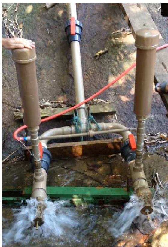
Figura 3.18- Perda de vazão no funcionamento dos carneiros hidráulicos
