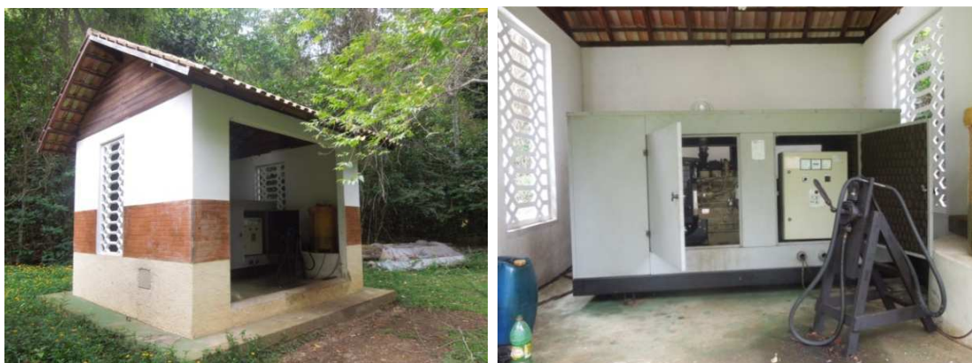
Figura 3.4- Central de geração diesel
