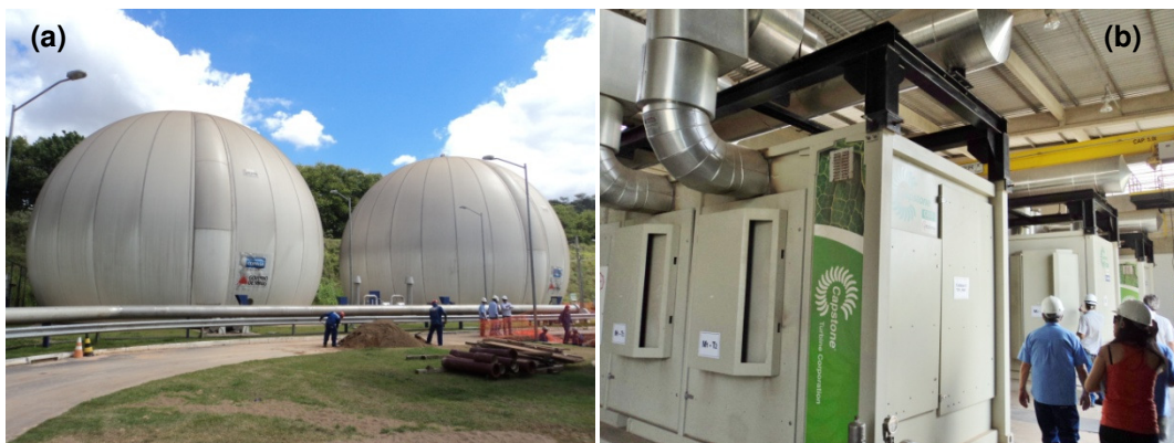
Figura 15: (a) Gasômetros e (b) Turbinas operacionais para a geração de energia elétrica na ETE Arrudas de Sabará/MG (Fonte: autor com autorização da COPASA)
