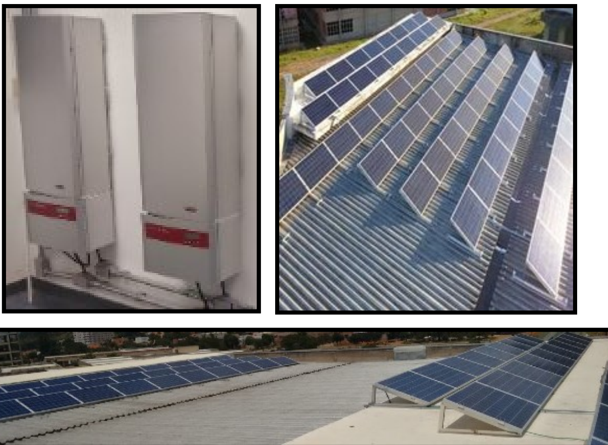
Figura 1.2: Sistema Fotovoltaico de instalado no Centro de Excelência em Redes Elétricas Inteligentes (CERIn) no campus da Universidade Federal de Itajubá (UNIFEI).
