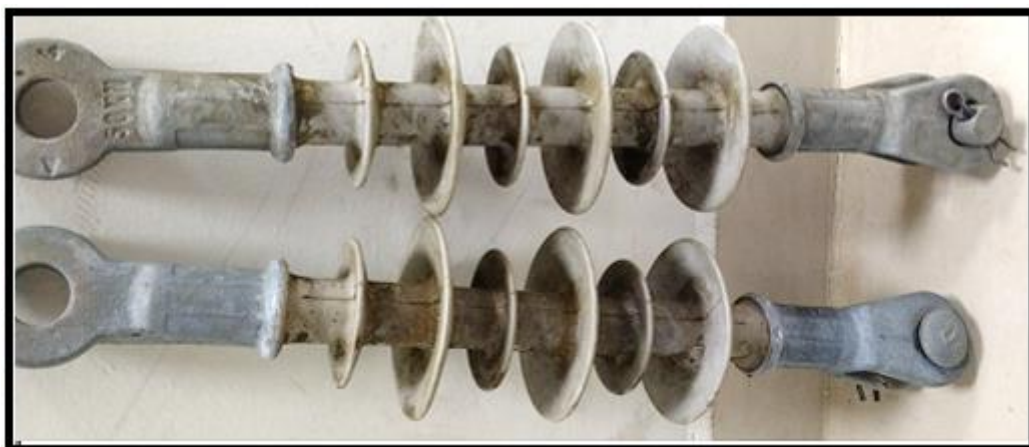
Figura 15 - Isoladores de alta tensão com biofilme.
