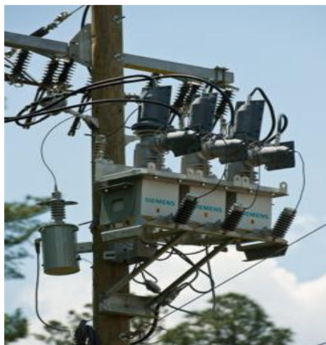
Figura 3.10 - Religador Microprocessado em Uso no Sistema Elétrico (SIEMENS).
