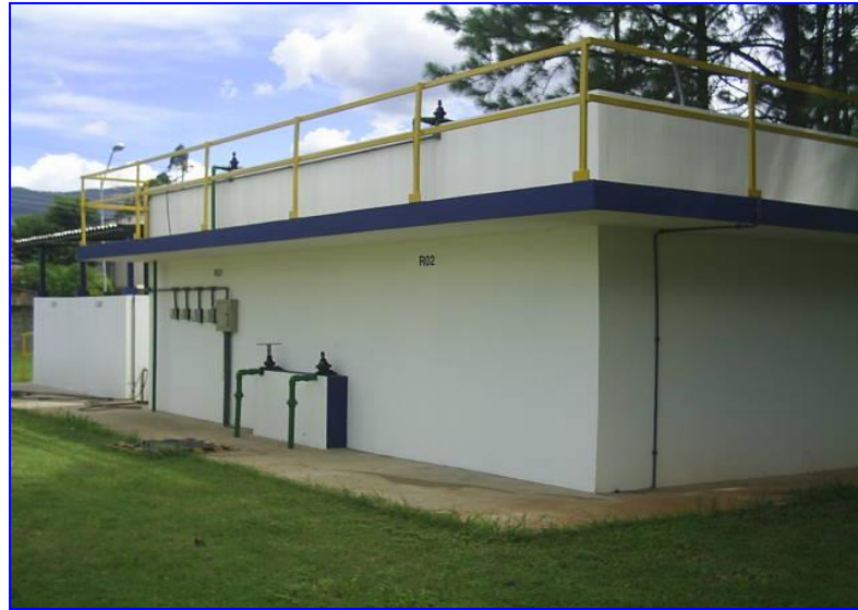
Figura 21: Estação de tratamento de efluentes - ETE da Empresa Automotiva C
