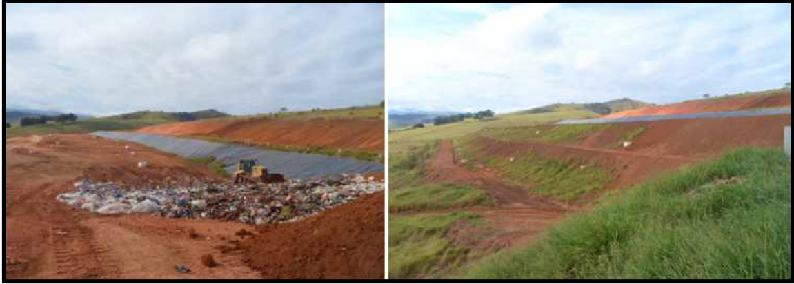
Figura 11 - Unidade de aterramento do aterro sanitário
