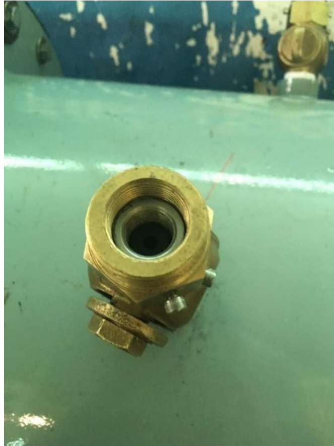
Figura 6.6. Válvula de instalação dos transdutores
