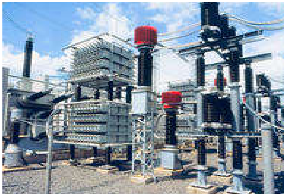
Figura 3.3 - Capacitor de comutação
