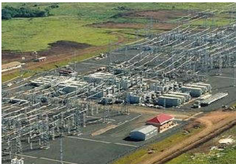
Figura 3.1 – Estação conversora de Garabi.
