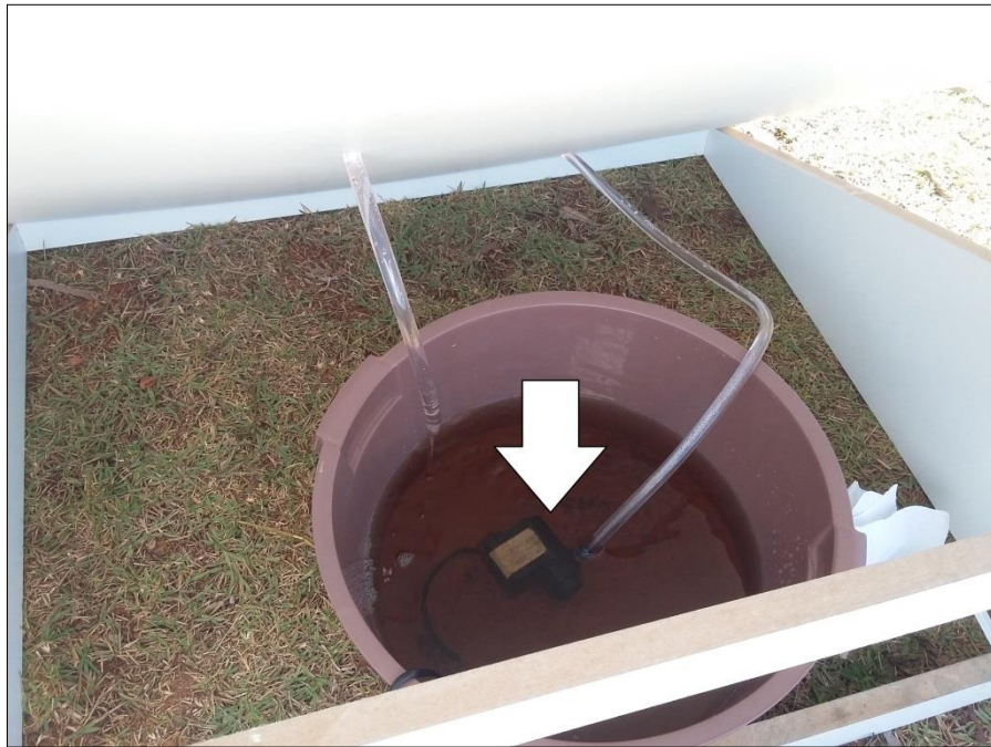
Figura 12 - Interior do reator demonstrando a conexão entre mangueira e bomba no reservatório de efluente
