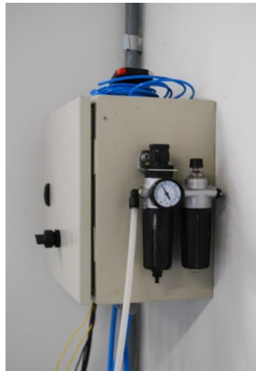
Figura 165 – Unidade de controle e preparação do ar comprimido
