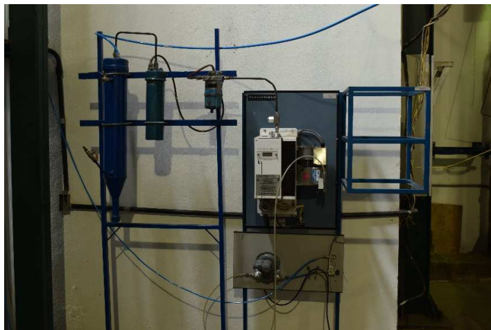
Figura 3-16 Sistema de Limpeza de Gases na Saída do Gaseificador.
