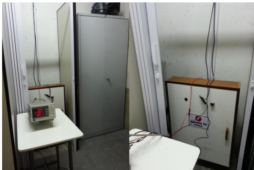
Figura 5.5: Divisão do almoxarifado do 1º piso dos equipamentos variador de tensão e transformador elevador.
