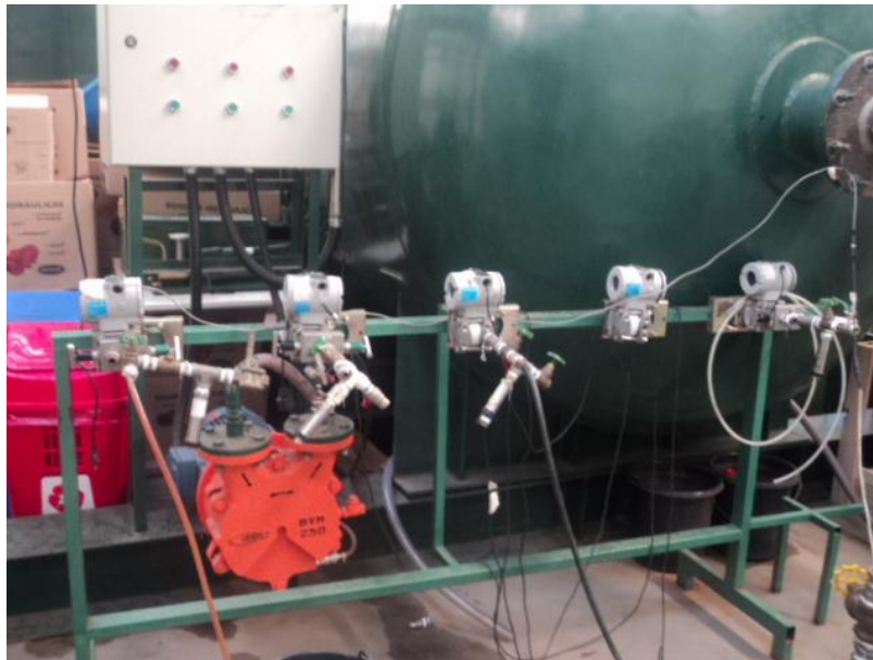
Figura 5.9: Transdutores de pressão nivelados.
