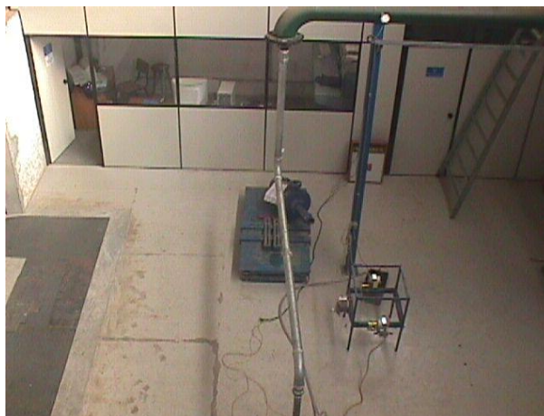
Figura 4.3: Vista da linha de sucção e da linha principal de recalque.
