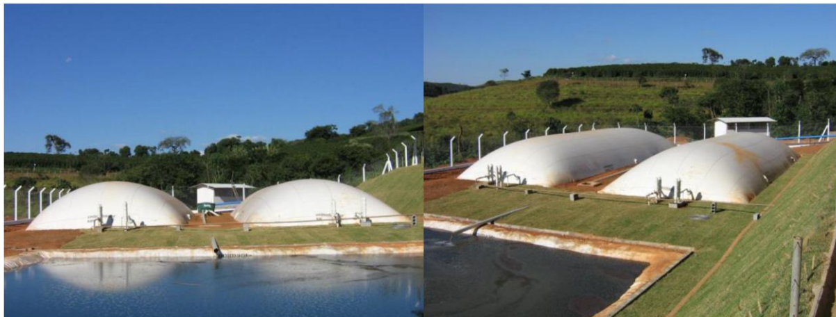
Figura 3.9 – Biodigestor tipo canadense instalado em IFSULDEMINAS – Campus Muzambinho
